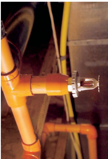
Impianto a pioggia (sprinkler)
